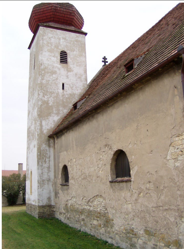
Věž a severní průčelí lodi v pohledu od severozápadu. Foto: Jan Koloc 2006.
