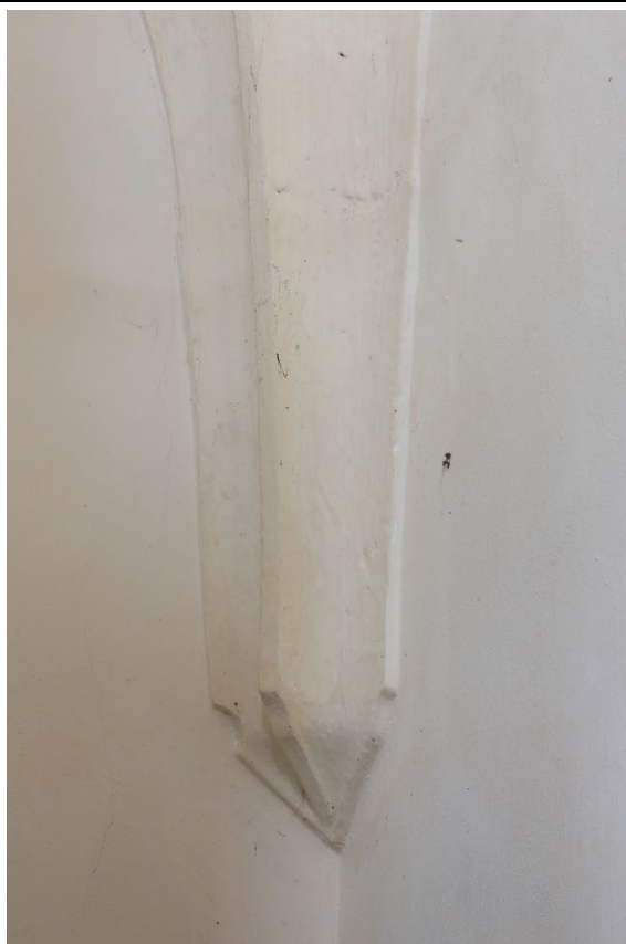
Detail klenebního výběhu v severovýchodním koutě presbytáře v pohledu od jihu. Foto: Marta Pavlíková 2018.
