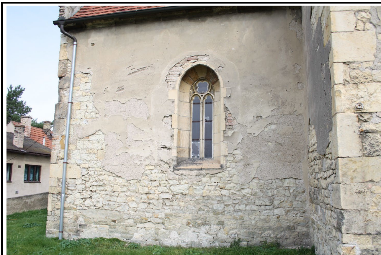
Západní část jižního průčelí lodi v pohledu od jihu. Foto: Jaroslav Skopec 2017.
